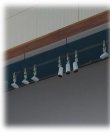
ステージ天井の照明器具です。
