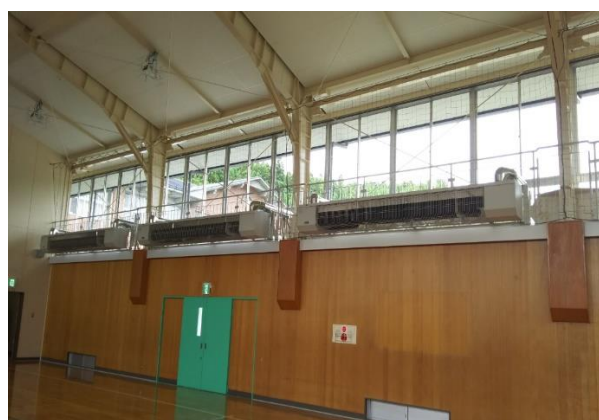
暖房設備は左右3台ずつ6機設置されました。
